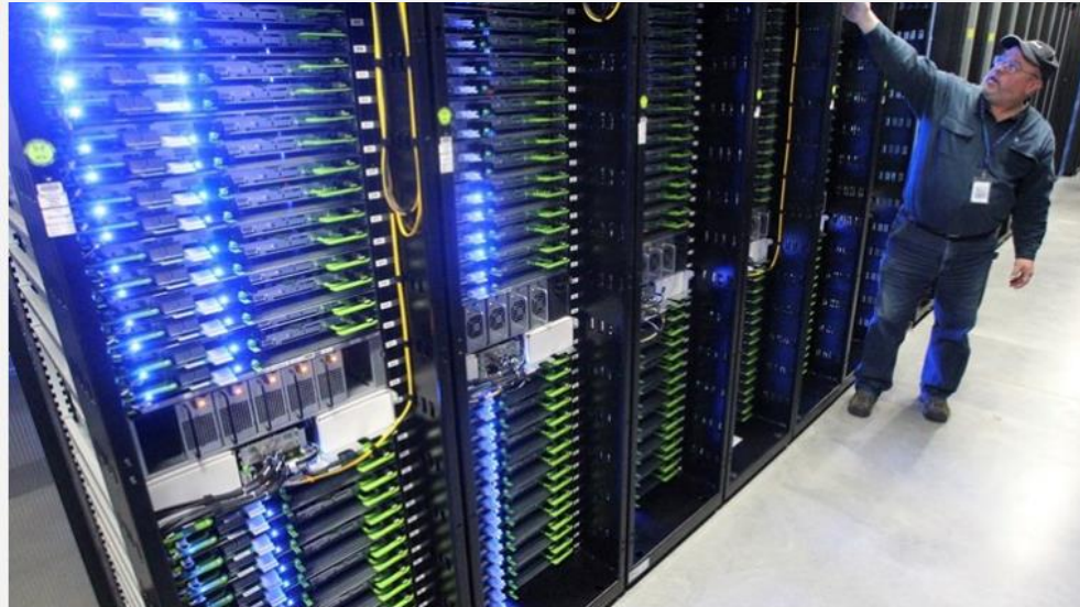
Ett av Facebooks datacenter. Foto: Andy Tullis/AP
